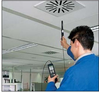
Mesure de la concentration en CO2 dans les gaines de soufflage et d'extraction
